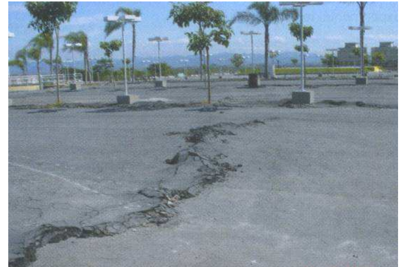
Gonflement d'une chaussée contenant des laitiers LD [da Silveira et al., 2005]
